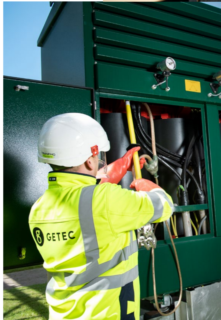
Jamie Nijholt, technischer Spezialist, bewegt die Erdung eines Hochspannungstransformators. Raymond Harms, technischer Spezialist (nicht im Bild), überwacht.
